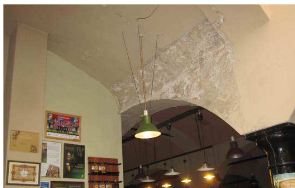
Obr. č. 5: Ukázka vlhkostních poruch v interiéru restaurace v důsledku zatékání skrze střešní konstrukci.
