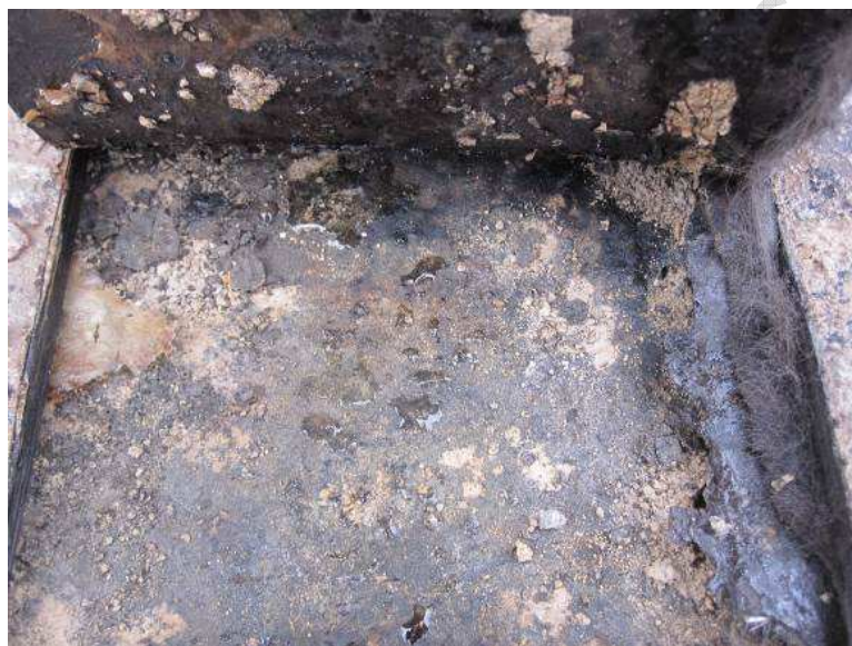
Obr. č. 8: Přítomnost srážkové vody pod hlavním hydroizolačním souvrstvím.
