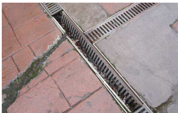
Obr. č. 4: Původní stav liniových žlabů.
