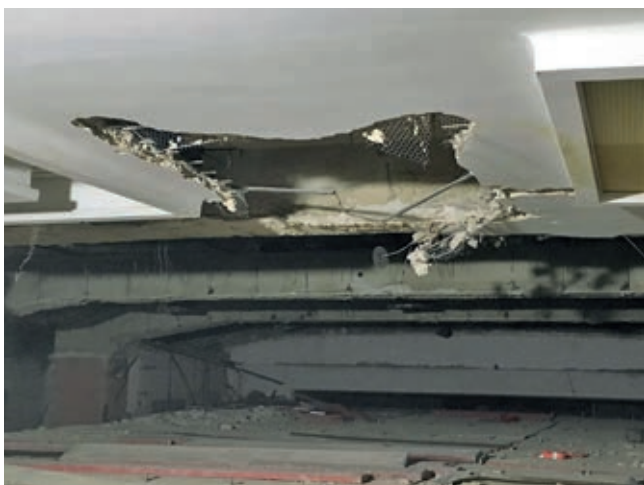
Degradace stropních konstrukcí
